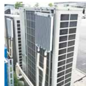
安城工場 / エアコン室外機
