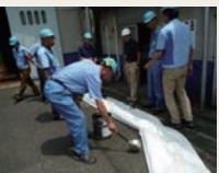
漏洩した油の汲み取り
