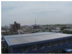
事務所屋根に設置したルーフシェード(安城事業所) ▶
