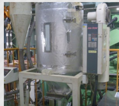
豊橋工場／材料乾燥機 遮熱シート対策
