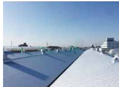
安城工場 / 工場屋根の断熱カバー
