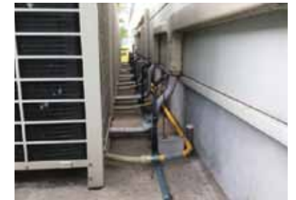
安城工場 / 空調室外機への散水
