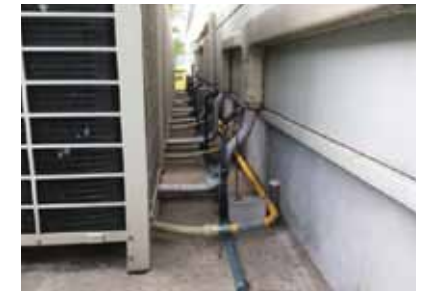
安城工場 / 空調室外機への散水
