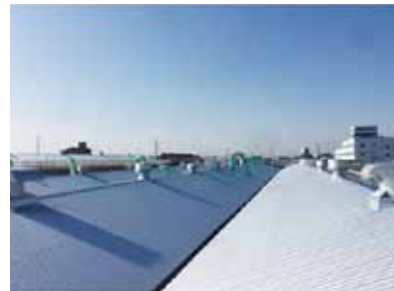
安城工場 / 工場屋根の断熱カバー
