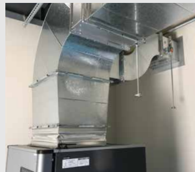
コンプレッサーの排熱利用
