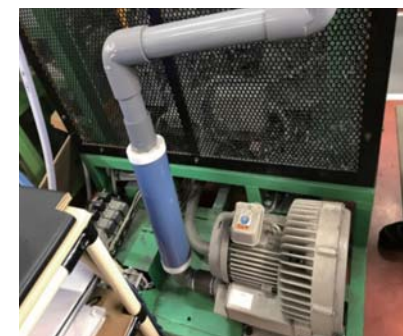
北九州工場／ファン排熱の排出/取り込み
