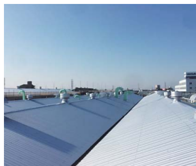
安城工場／工場屋根の断熱カバー
