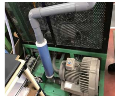
北九州工場／ファン排熱の排出/取り込み
