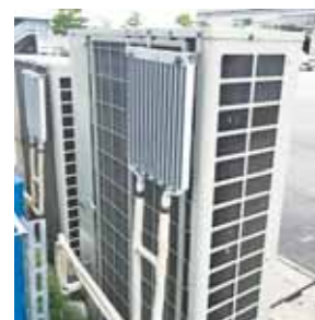
安城工場/エアコン室外機
